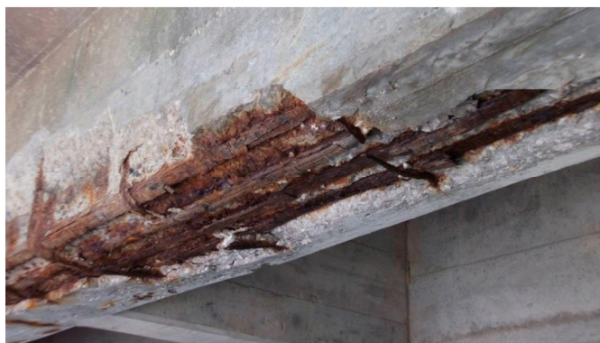
Hình 1.5. Ảnh hưởng của ăn mòn cốt thép trong dầm BTCT.
